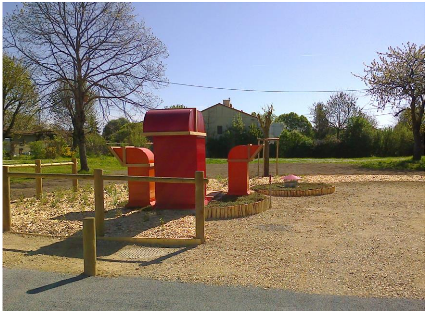
Figure 2 : poste Refoulement Amuré
