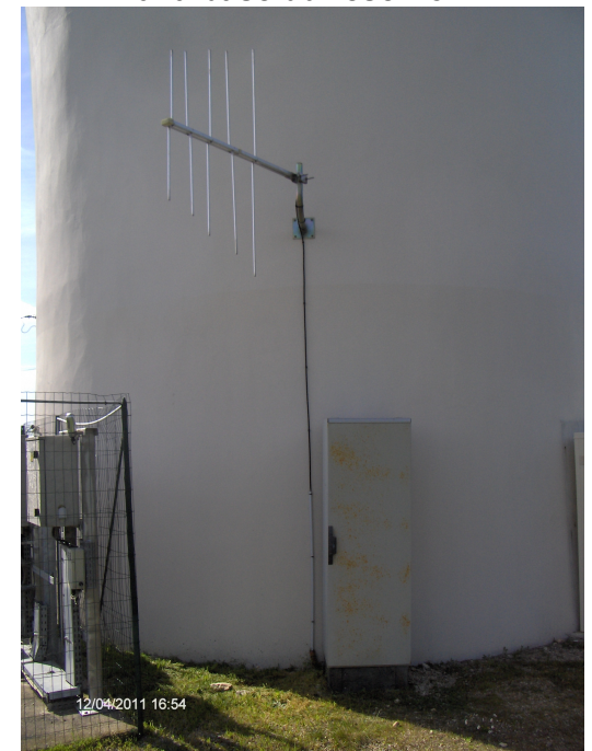
Armoire technique et antenne réception extérieure, à la base du réservoir
