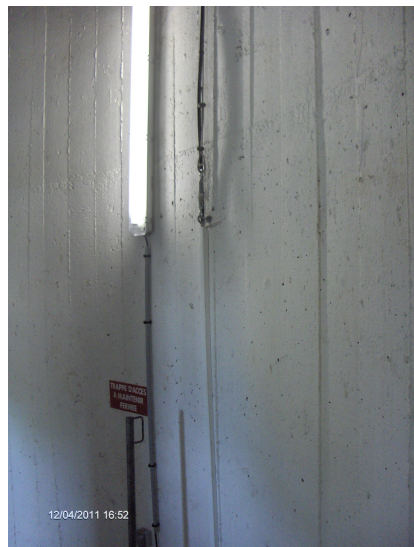
Chemin de câble D4B bas du fût
